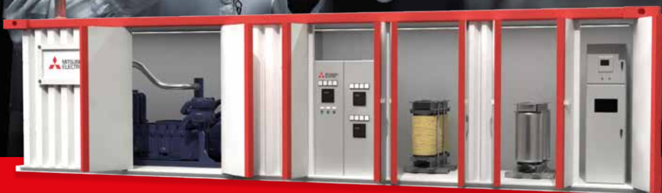
Central eléctrica en contenedor
